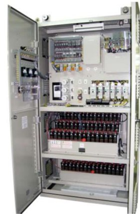
非常用電源装置
